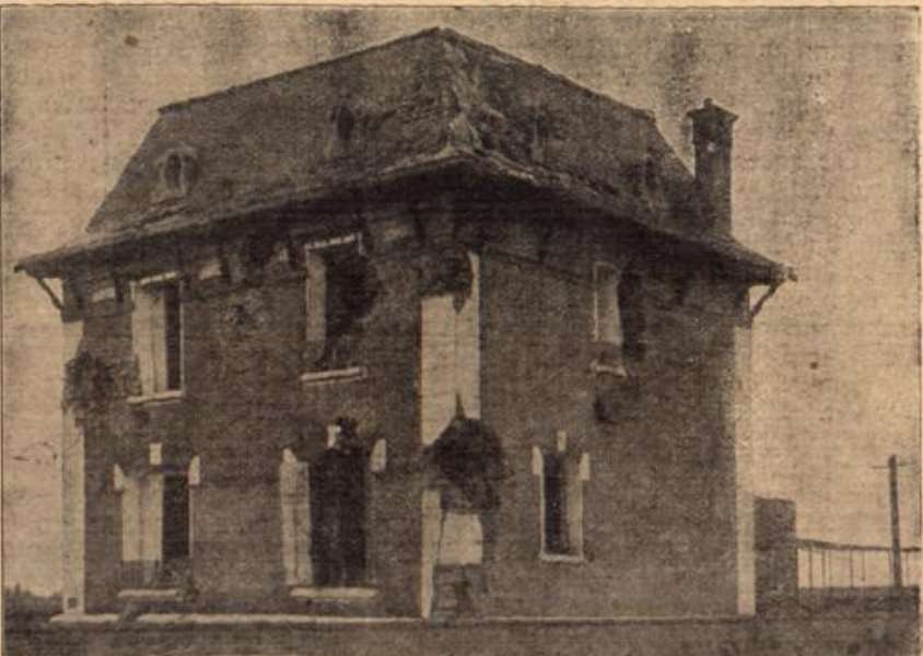
Ein Haus aus dem Feuerbereich von Etain. Daß es trotz der zahlreichen und schweren Treffer nicht zusammengestürzt ist, mag als ein besonderer Glücksfall anzusehen sein.
