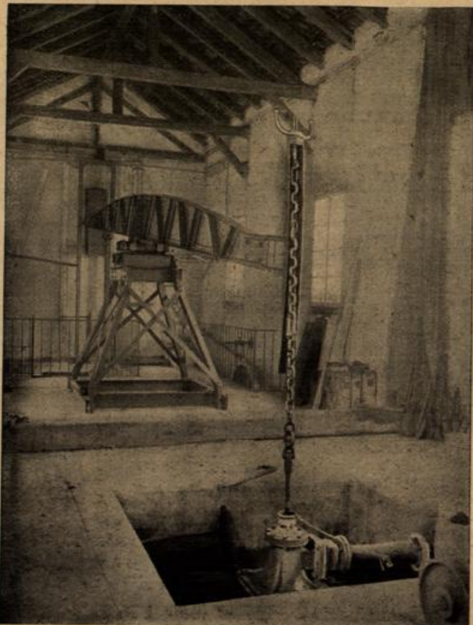
Innere eines Bohrturmes nach der Inbetriebsetzung, im Hintergrunde große Pumpenanlage.
